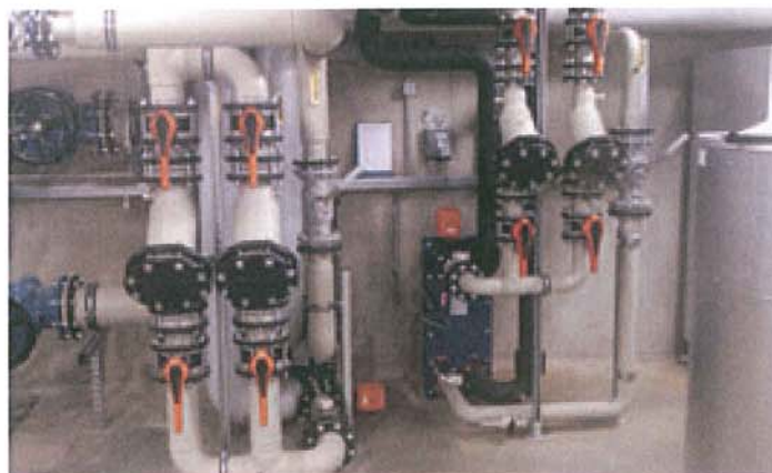
2. Mijnwaterstation in cbs-gebouw.
